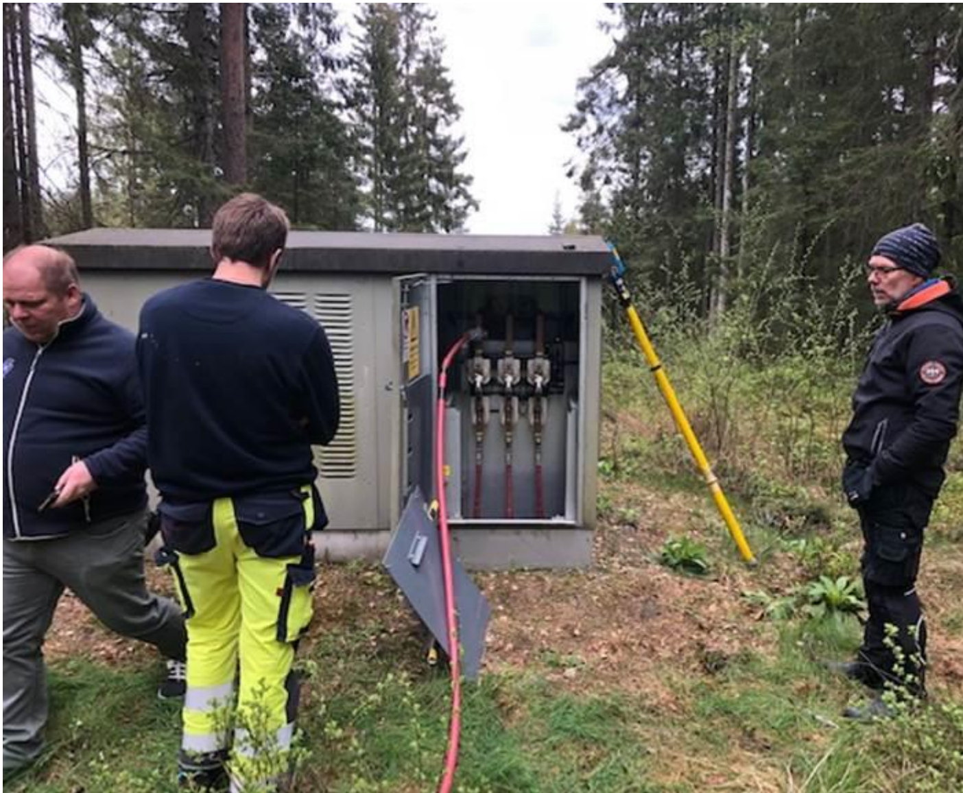
Jordfel anbringas i radialmatad nätstation.
